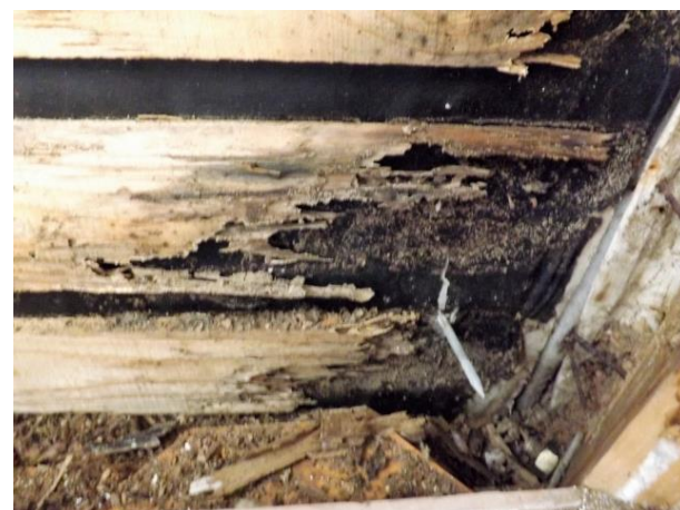
暗い床下や水周りはシロアリが大好きな場所
